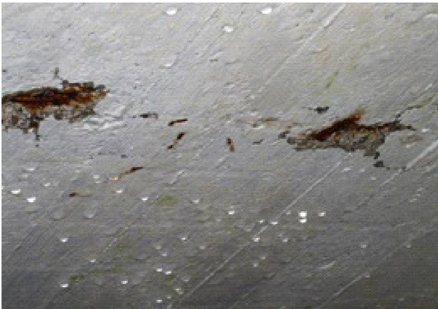
Tropfen und Korrosionsschäden durch zu hohe Luftfeuchtigkeit
