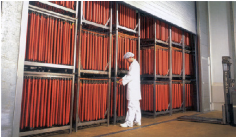
Im Reiferaum befinden sich Kanäle für Ansaugluft und Umluft, was die Luftumwälzung verbessert. Dank der Luftentfeuchter von Munters kann die Luftfeuchtigkeit exakt gesteuert werden.
